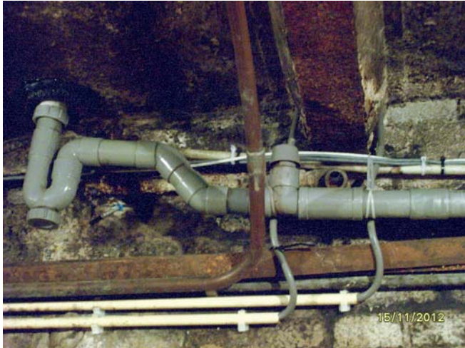
Figuur 17.10 Foutief geplaatste beluchters. Links is de sifon te zien. De beluchter is in het midden geplaatst, dit is echter niet het hoogste punt.
